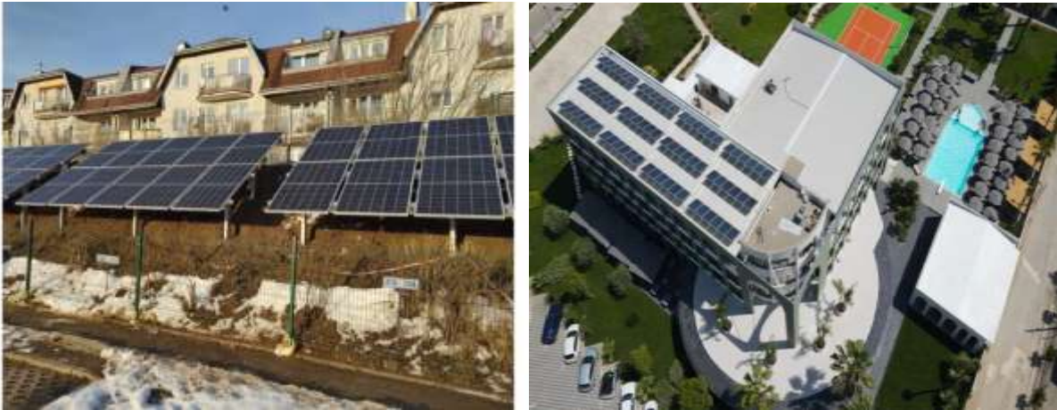
Слика 18 ПВТ Инсталација за загревање на топла вода- ПВТ систем на станбен објект во Варшава и на Хотел со базен во Албаниа вода
