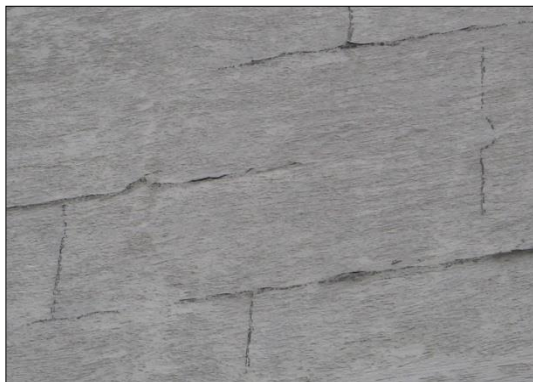
Слика 1.1.36: Пукнатини во финалниот фасаден малтер
